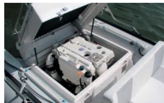
Sauber installiert: Alle wichtigen Aggregate des TDI sind zur Wartung gut zu erreichen
